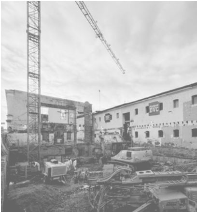
REGISTRO FOTOGRÁFICO DE RUINA
