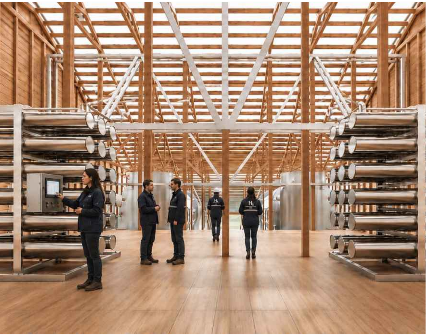
Interior modulo antiguo: Zona de Ósmosis inversa
