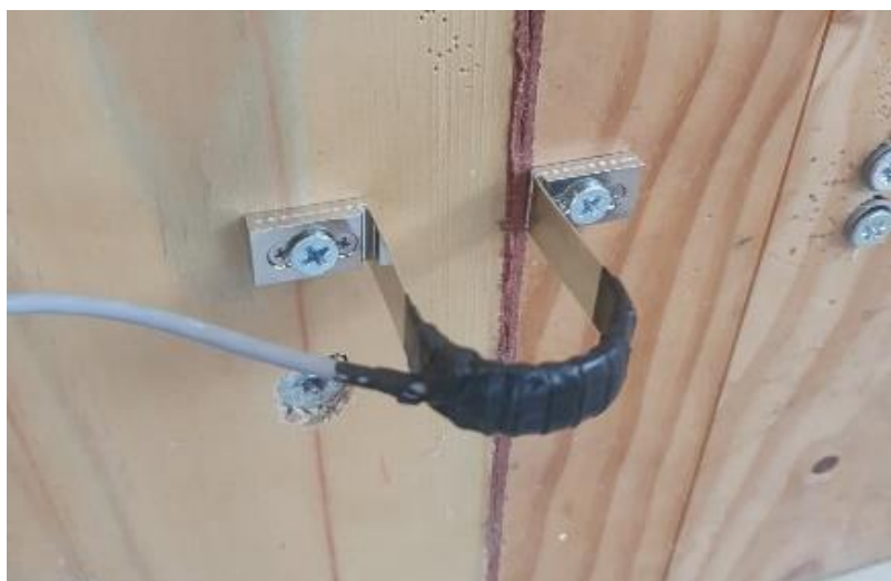
Implementación de sensores de desplazamiento.
