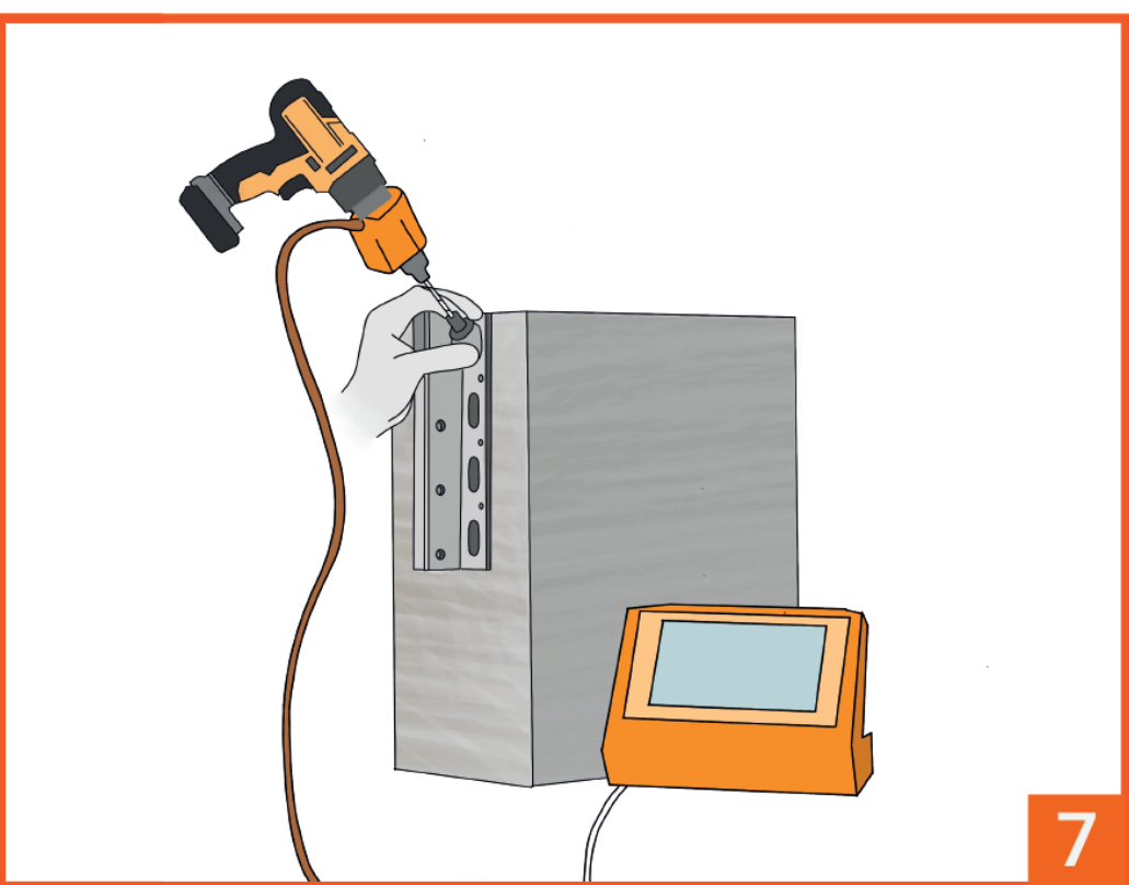
Herramienta: Desgaste de broca, desgarros de fibra
