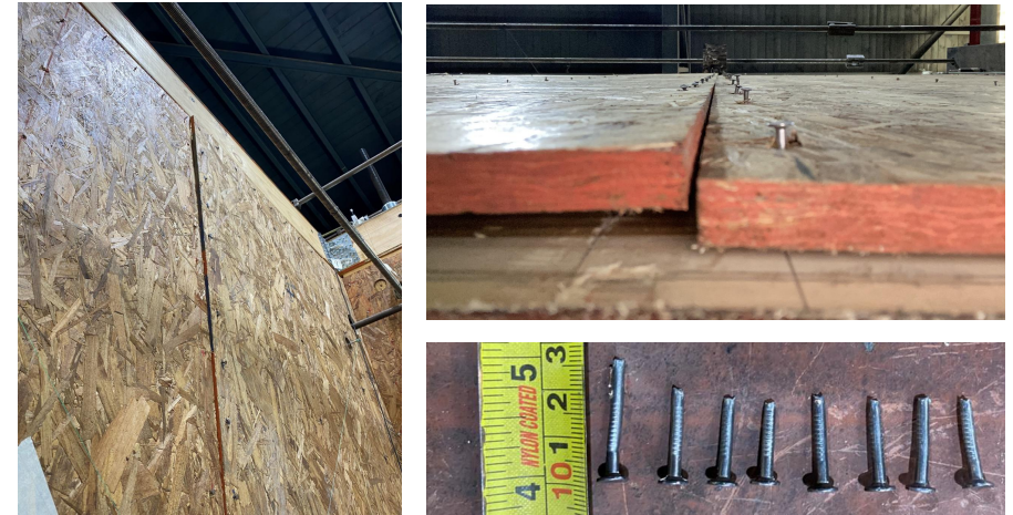
Figura 5: Daño evidenciado en el muro central de la configuración no planar en T
