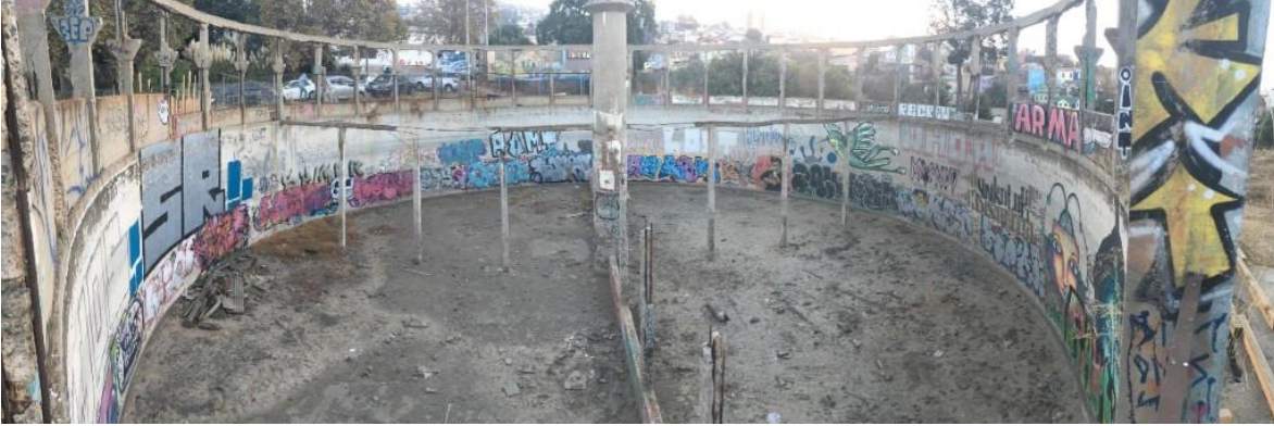
Ilustración4 Estanque de Agua en desuso
