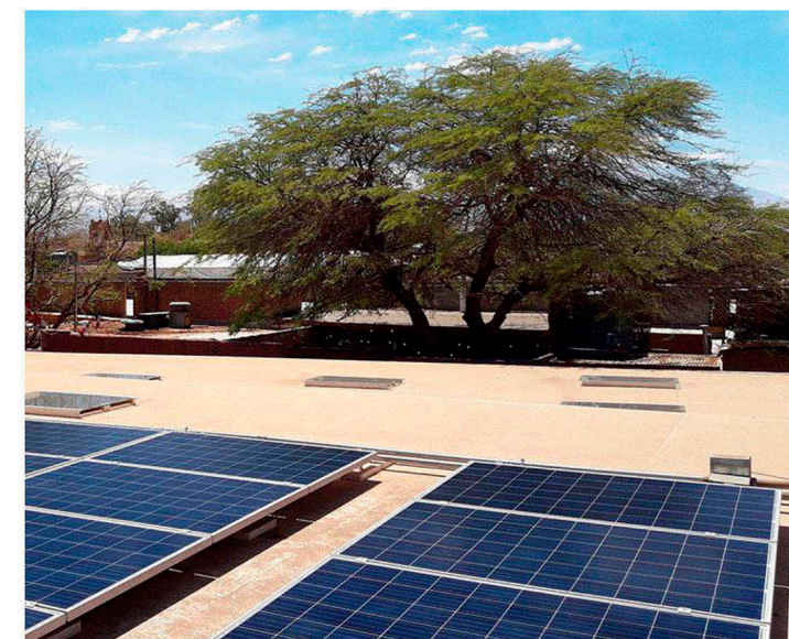
Paneles solares para abastecer las 17 Tiendas.
